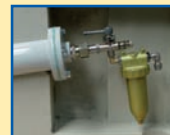
Prise de gaz avec isolation thermique
