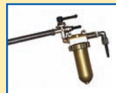
Prise de gaz sans isolation thermique
